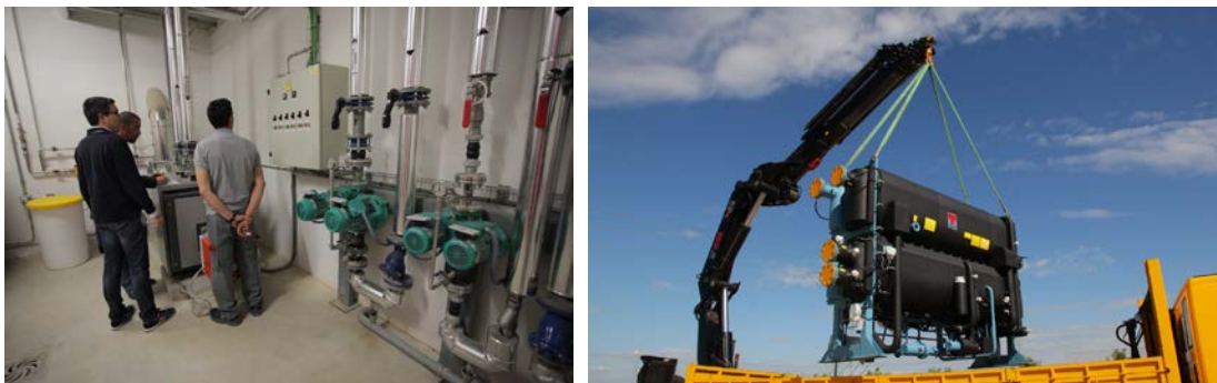
Figura 5: Proyecto Enering Life+, Instalaciones y máquina de absorción Thermax LT10
