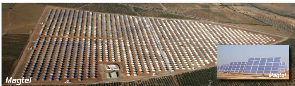
Figura 1. Imagen Aérea Instalación Fotovoltaica objeto de Estudio.
