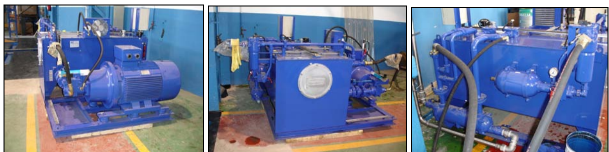
Figura 12: Vistas generales del grupo hidráulico incorporado en el banco
