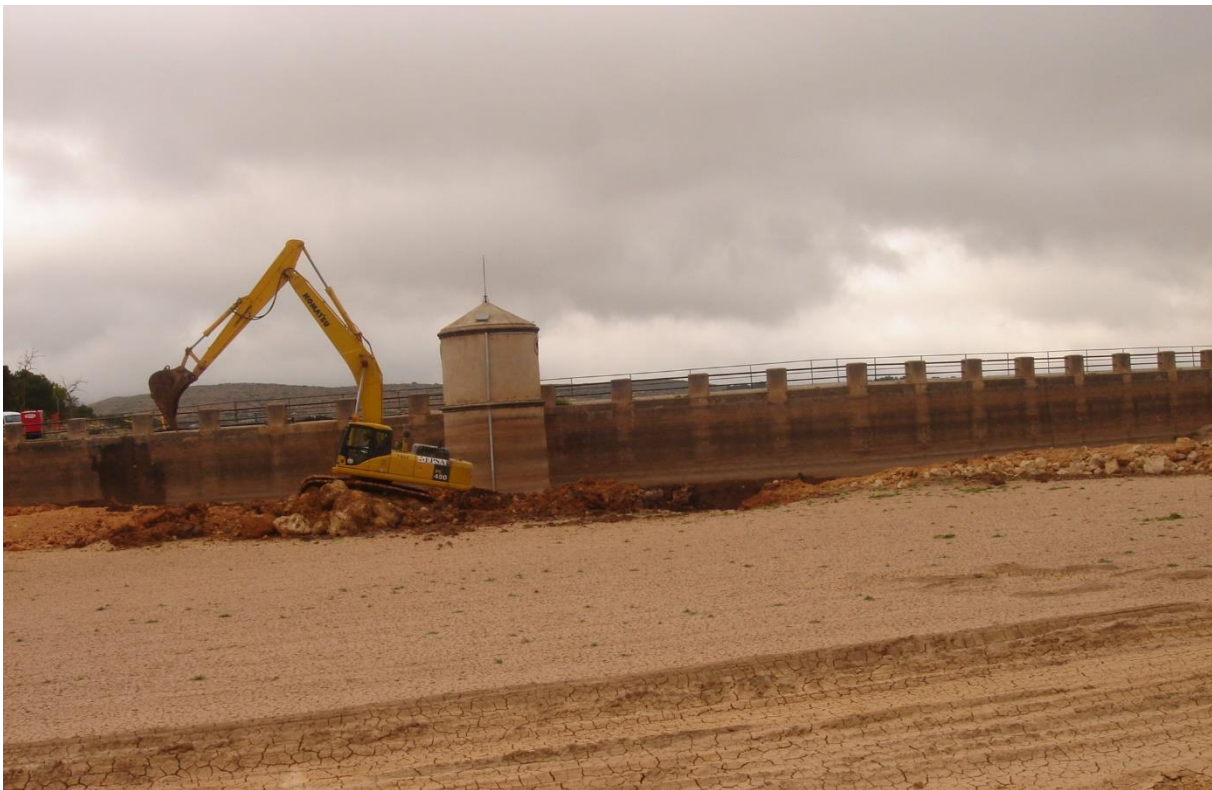
Figura 3 Inestabilidad de la retroexcavadora giratoria sobre los lodos al efectuar la excavación.
