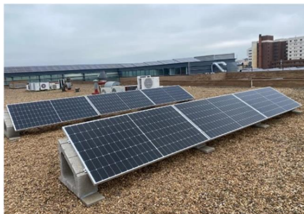
Figura 3. Foto de la instalación PV real ubicada en la cubierta de la Escuela de Ingenierías Industriales (Universidad de Extremadura).
