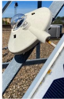
Figura 4: Piranómetro de Kipp & Zonen serie CMP 11 con una inclinación de 30° al sur ubicado en la cubierta de la Escuela de Ingenierías Industriales de Badajoz.
