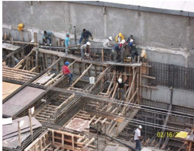
Figura 2: Condiciones inseguras de andamios. Fuente propia.
