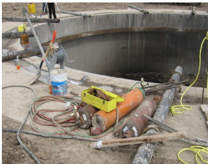
Figura 1: Excavación sin barandal de protección y desorden general. Fuente propia.
