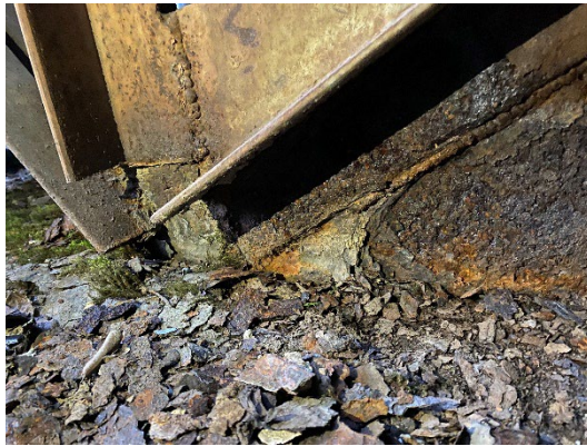
Ilustración 7 Nudo de la compuerta con importantes corrosiones
