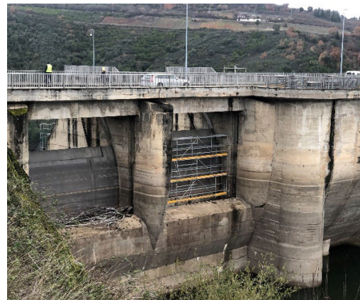
Ilustración 2 Vista desde aguas arriba. Véase árbol en aliviadero
