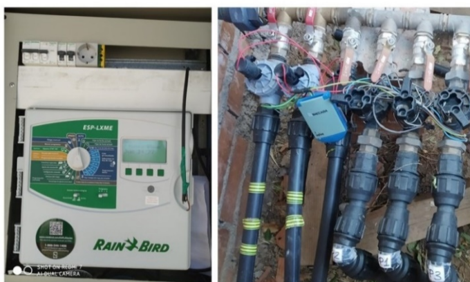
Figura 8: Sistema programador que plantea instalar el GOP para el control y la cuantificación del riego
