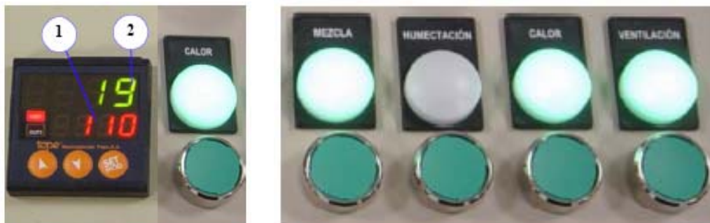
Figura 9. Regulador de temperatura y pulsador accionador + lámpara y Accionamiento de los subsistemas de mezcla ("Mezcla") y humectación ("Calor" y "Ventilación")
