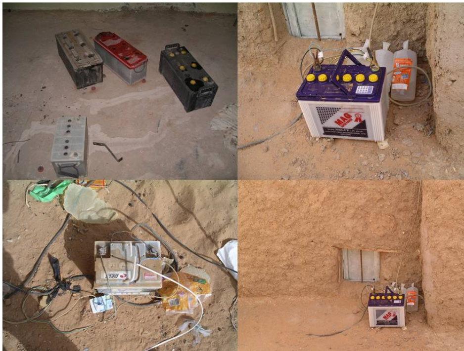
Figura 6. Situación inadecuada de las baterías
