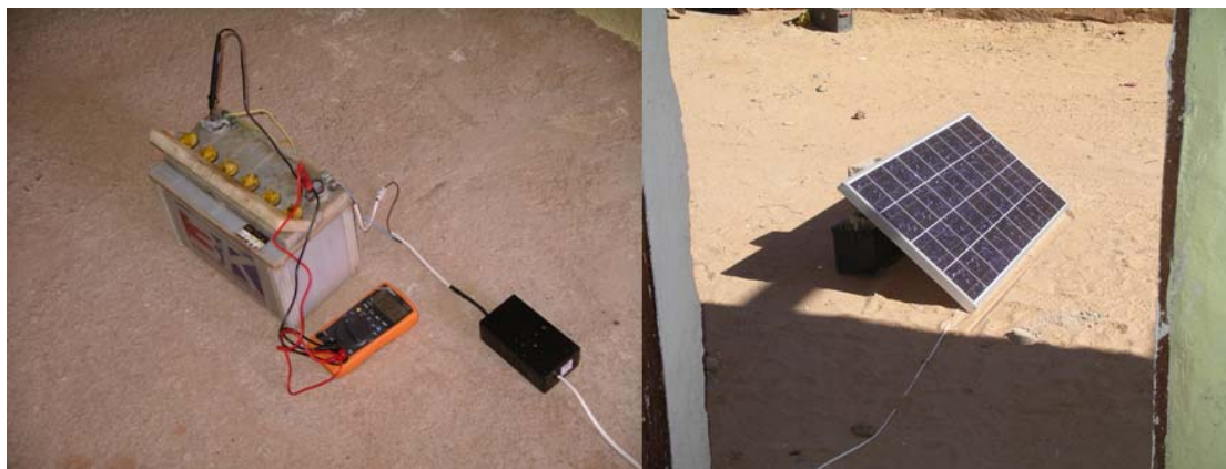
Figura 3. Instalación de prueba del regulador de carga.
