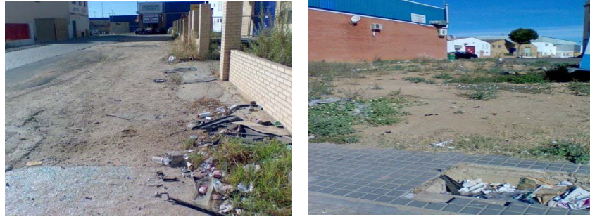
Figura 1. Deterioro de infraestructuras y ausencia de mantenimiento en un área industrial.
