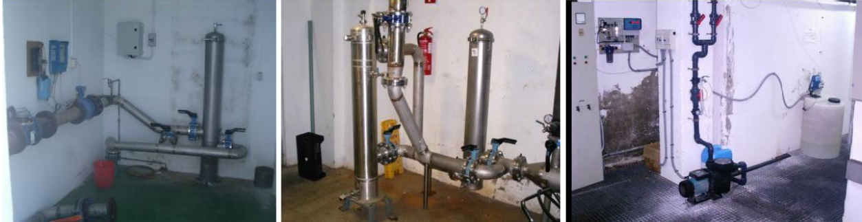
Figura 2: Filtros de agua fría, agua caliente y equipo de cloración en aljibes
