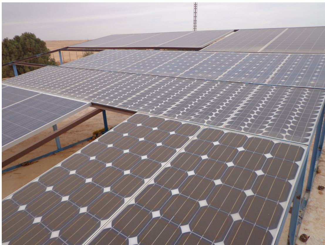
Figura 2: Ampliaciones de instalaciones FV existentes sin control de calidad
