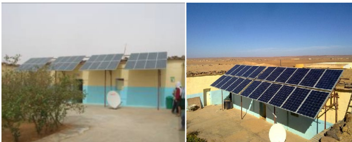
Figura 1: Cambios en el diseño de la instalación con respecto a lo originalmente recepcionado
