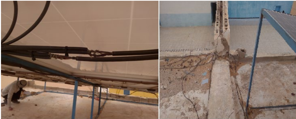
Figura 6: Malas prácticas detectadas en el cableado de los SFA
