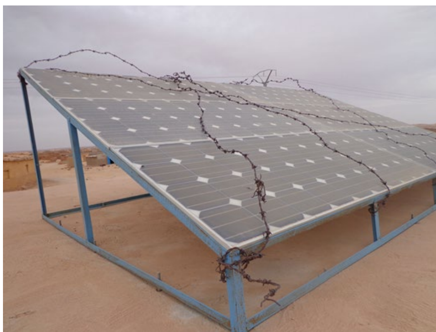
Figura 3: “Auto-sombreado” del generador fotovoltaico
