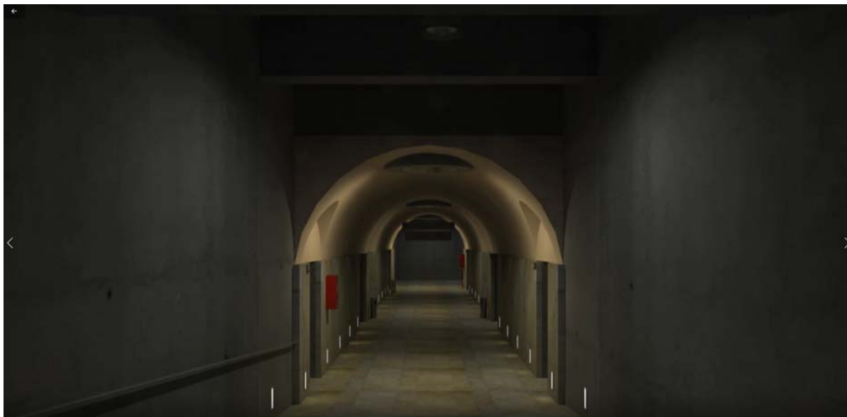
Figura 6: Iluminación en la planta bajo rasante del edificio
