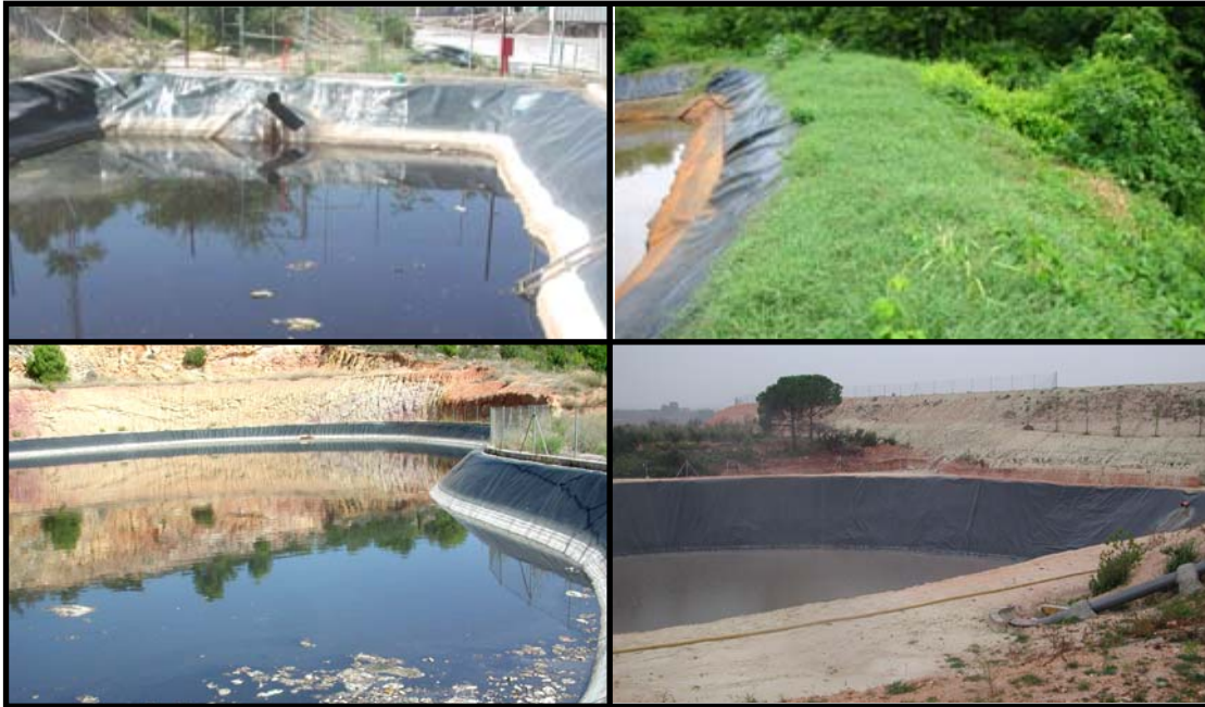
Figura 2: balsas de lixiviados con talud interior, talud exterior, impermeabilización y obras complementarias (tubería de entrada de HPDE, escalera de salvamento, vallado perimetral y anclaje de la tubería).
