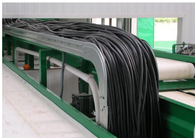
Figura 3. El tendido de cables debe cuidarse para evitar sobrecalentamientos
