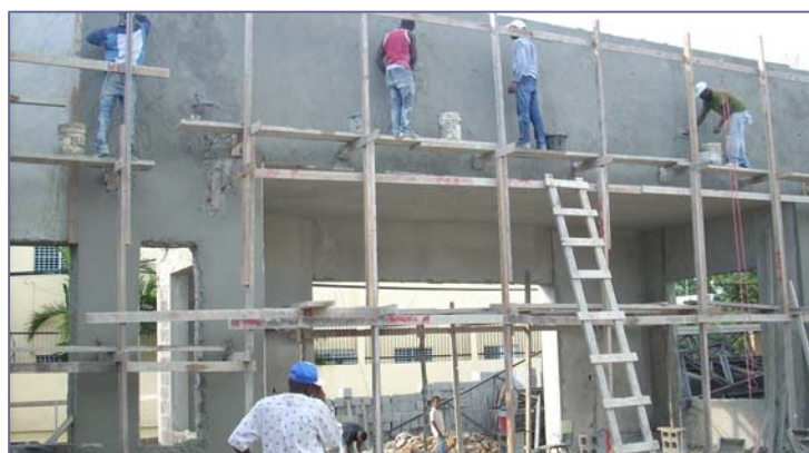
Figura 5. Falta de equipo de protección individual. Obras República Dominicana.
