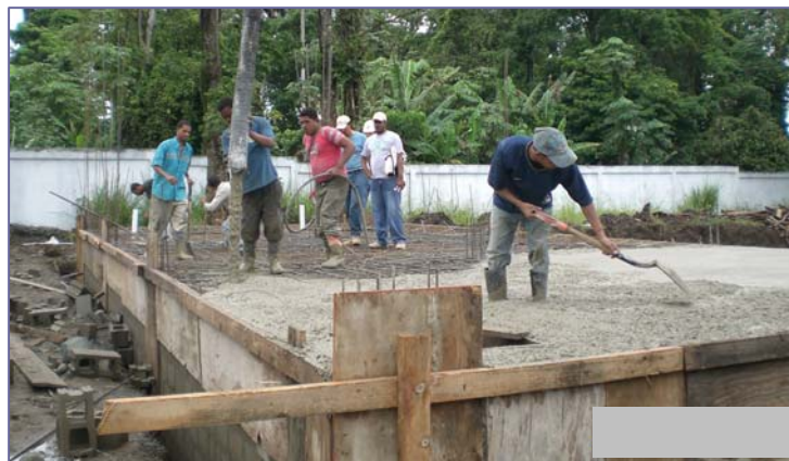
Figura 4. Falta de equipo de protección individual. Obras República Dominicana.
