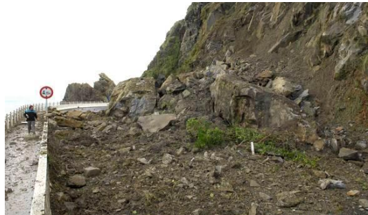
Figura 2: Desprendimiento producido en el punto de trabajo.
